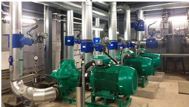
Рисунок 3 – Насосная станция тепличного комбината
