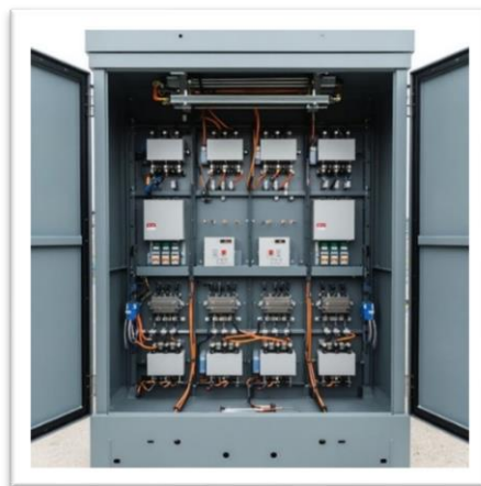
Рисунок 2 – Вид подстанции изнутри
