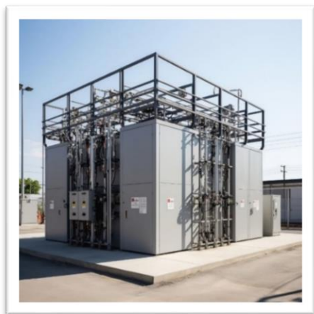
Рисунок 1 – Вид подстанции наружный
