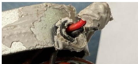
Рисунок 4 –Перелом поясной изоляции ПВХ кабеля в месте присоединения к электродвигателю актуатора
